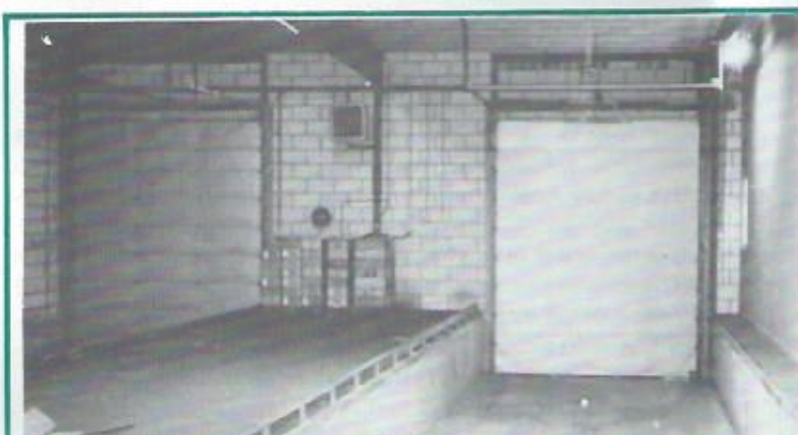
De twee laad- en losperrons maken het werk een stuk eenvoudiger.
